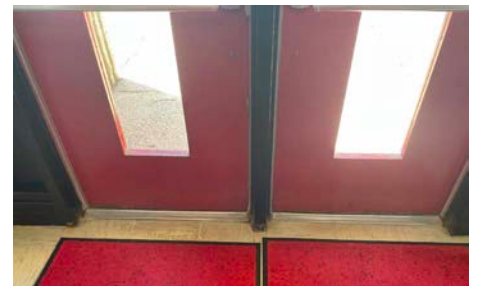
Rusting door frames
